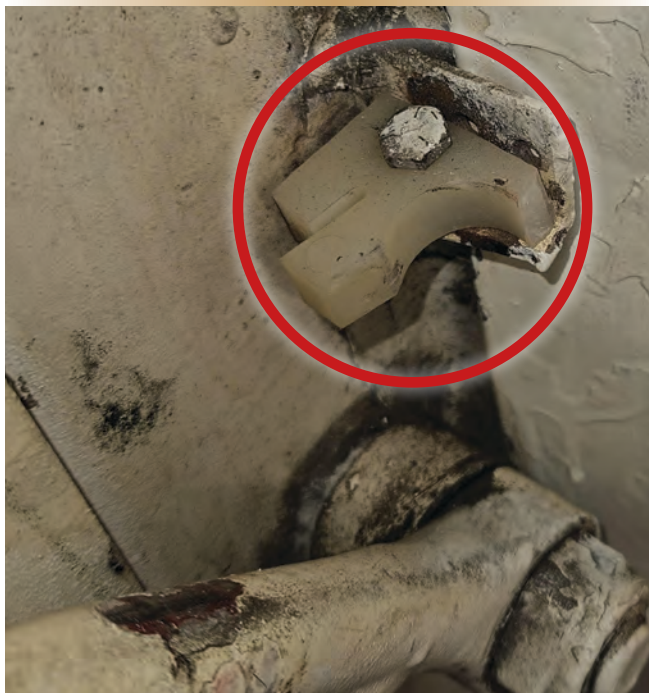
Figure 4. Dispositif de retenue de porte brisé. Le côté droit de l'encoche du dispositif de retenue s'est brisé et détaché, ce qui a empêché la poignée de porte de se fixer en place.
