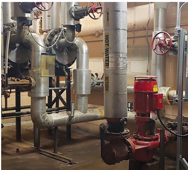
Ce système de distribution du chauffage hydronique a été modernisé à la BFC Kingston pour réduire la consommation d'énergie et la dépendance aux combustibles fossiles, dans le cadre du défi Énergie verte du programme IDEeS.
