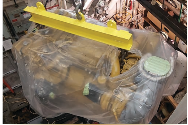
Figure 4. Un nouveau moteur Caterpillar CAT ACERT32, toujours dans son enveloppe protectrice, est monté dans la salle des machines auxiliaires arrière. Remarquer les dégagements serrés.
