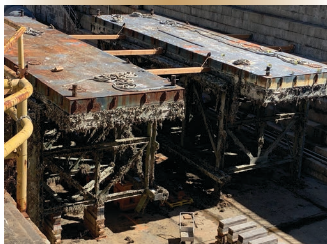
Figure 2. La croissance marine importante et les conditions troubles pendant l'inspection sous-marine ont caché l'ampleur des travaux qui seraient nécessaires pour réparer entièrement les chameaux. En fin de compte, les travaux de nettoyage et de réparation devaient être effectués sur deux fenêtres d'accostage distinctes.
