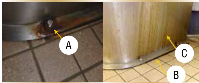
Figure 8. Corrosion de toilettes en acier inoxydable.
