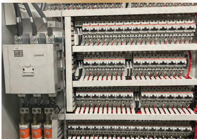
Panneau chauffant de dégivrage montrant les disjoncteurs.
