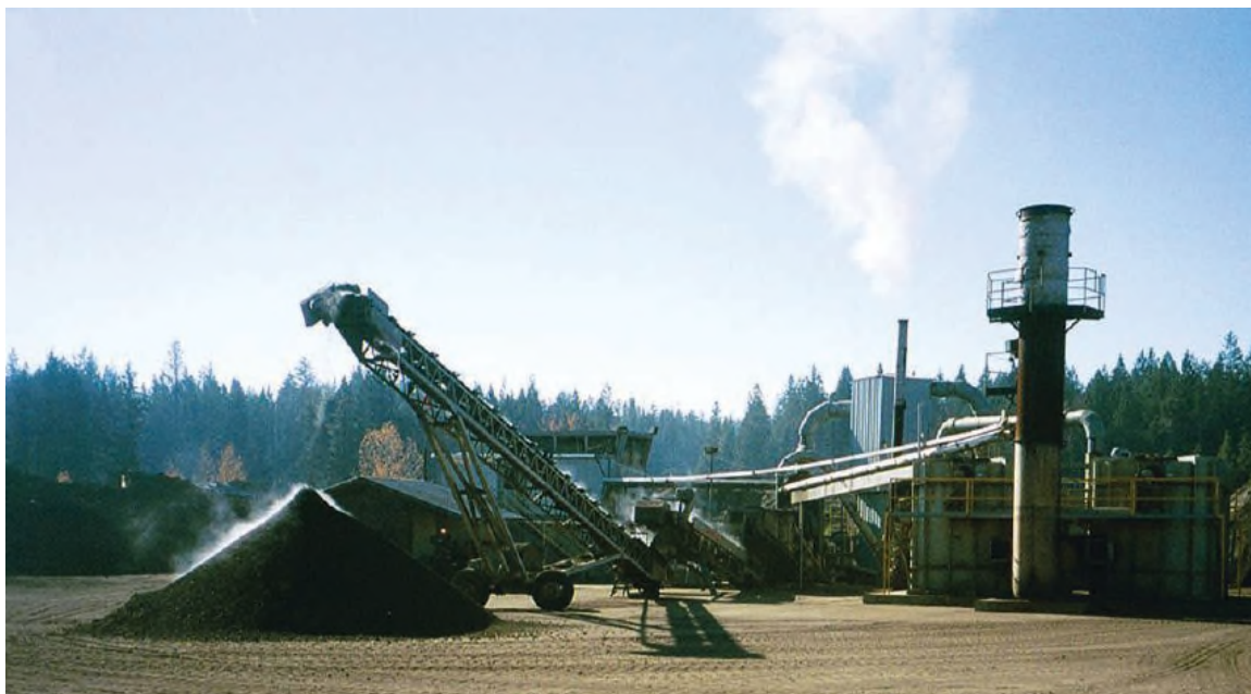
Figure EC1-5 : Installation de traitement thermique (reproduction autorisée par ECCC).
