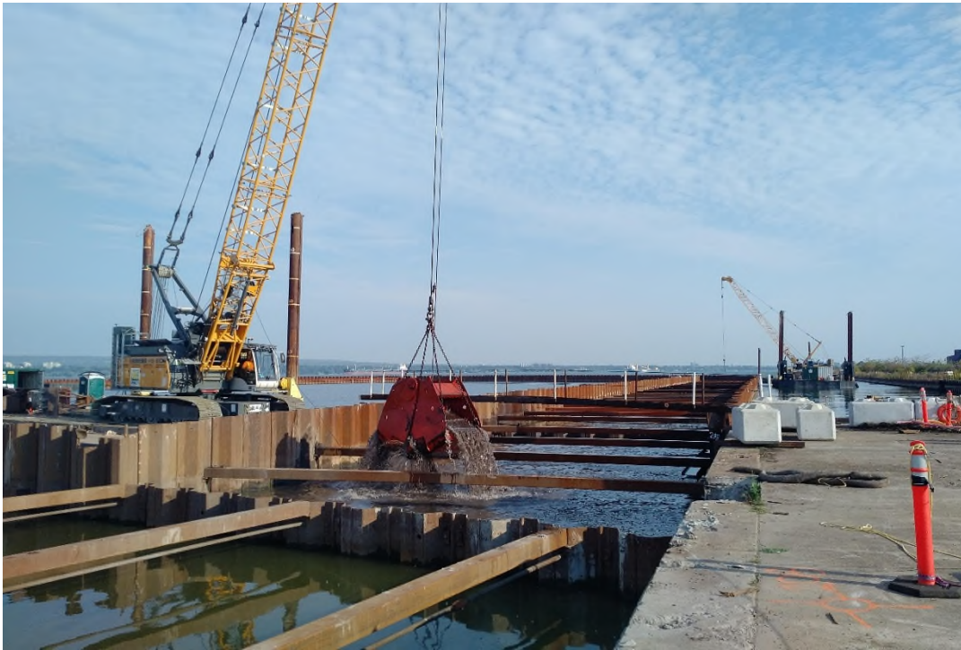
Figure EC4-5 : Le dragage mécanique a été utilisé pour retirer les sédiments contaminés entre les deux parois de l'ICA (reproduction autorisée par Riggs Engineering).
