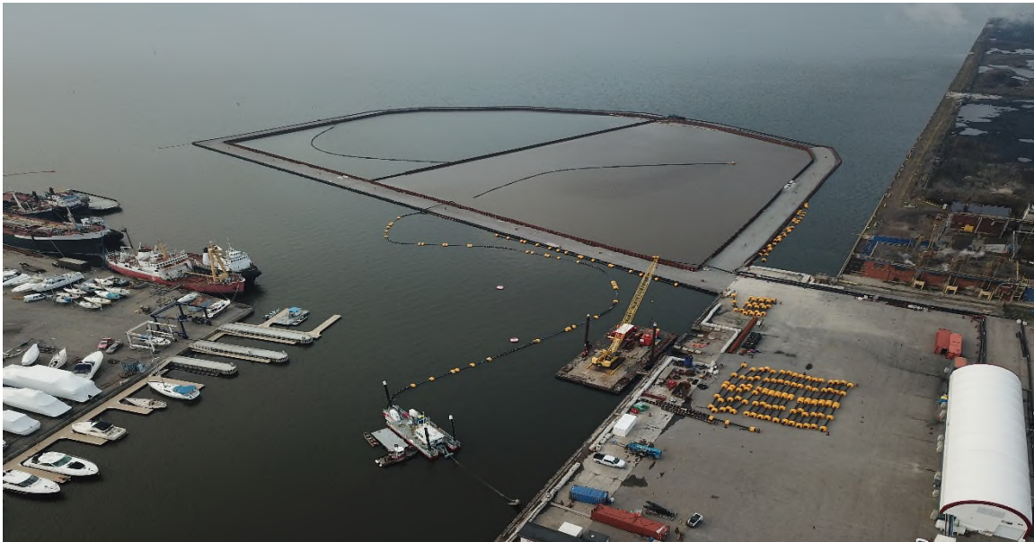
Figure EC4-9 : Photographie aérienne de l'ICA et des travaux de dragage prise à l'été 2019 (reproduction autorisée par Riggs Engineering).
