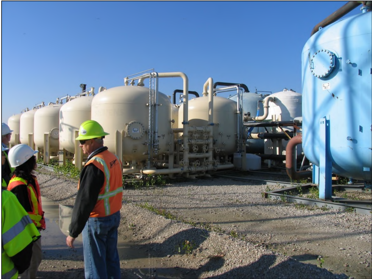
Figure 3-19 : Récipients de filtration par le sable et de nettoyage au charbon actif d'une usine de traitement de l'eau (reproduction autorisée par ECCC).
