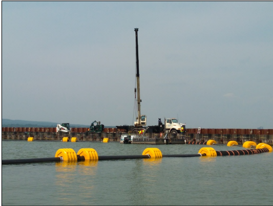
Figure 3-9 : Conduite flottante (reproduction autorisée par ECCC).
