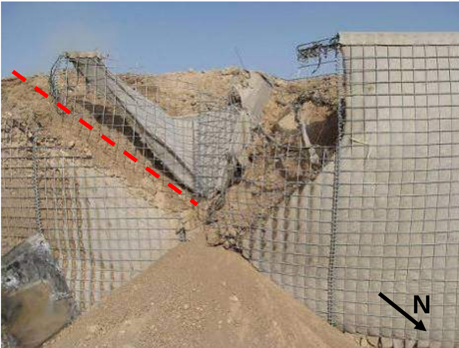
Photo 3 – Mur endommagé montrant l’endroit où une pale du rotor principal a heurté le mur.
