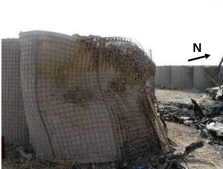
Photo 2 – Mur endommagé, du côté du point d'impact.
